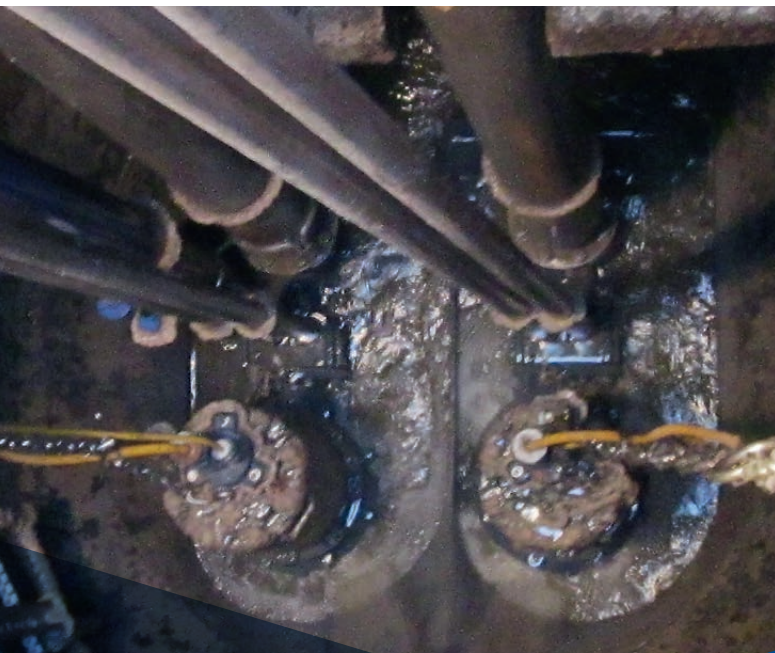
Pompput voorzien van PreroClean systeem
